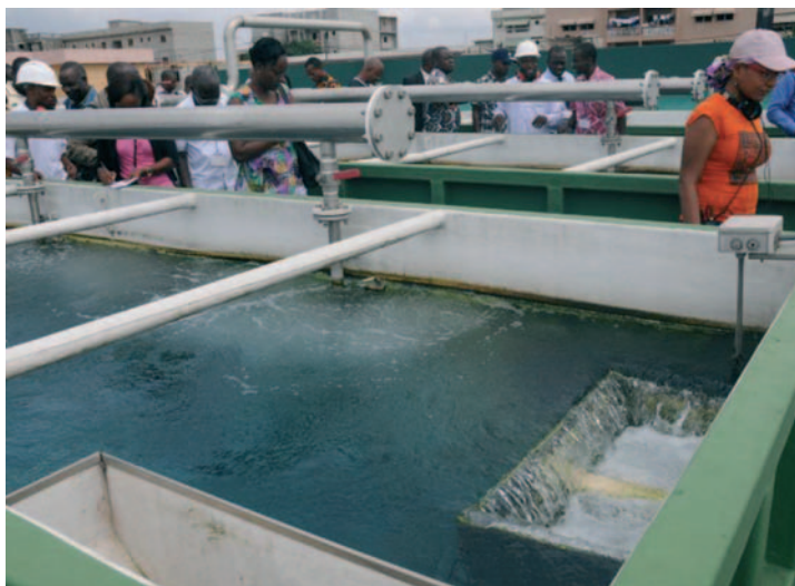
Une des zones de captation de la SODECI se trouvant au sein de la maison de production à Abidjan visité par des journalistes le 03 juillet 2013.
