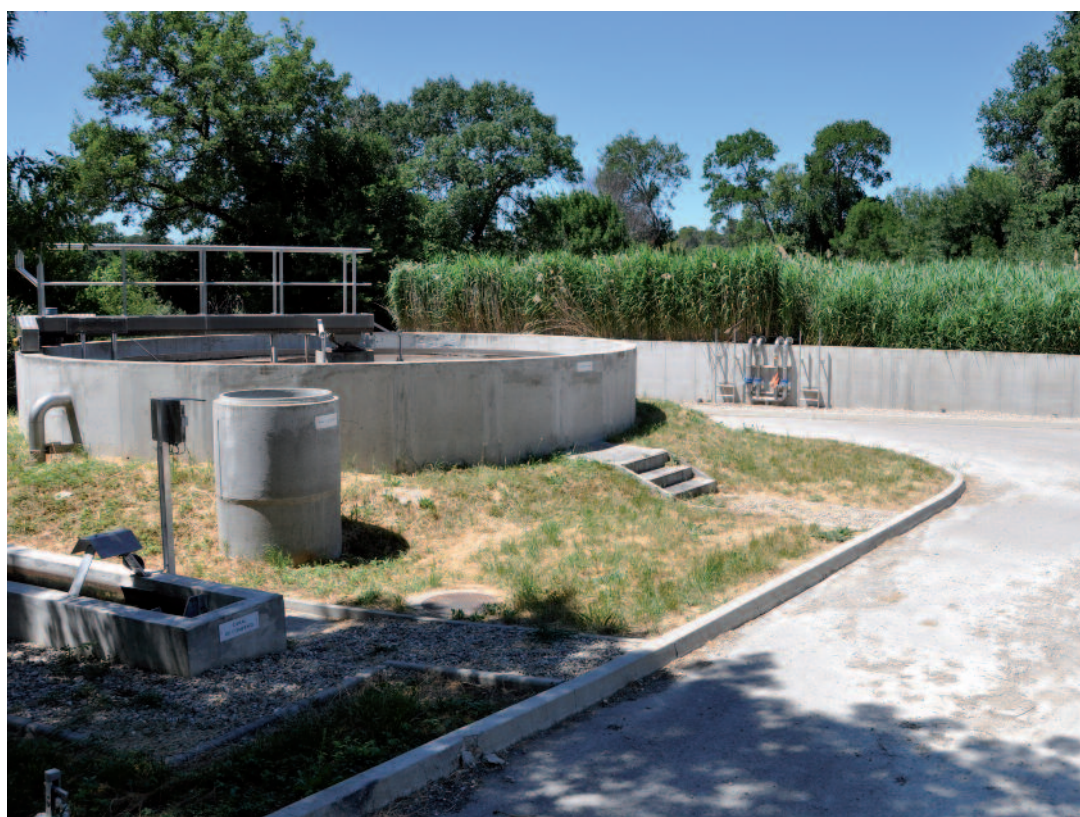
Figure 3. Usine de traitement de l'eau utilisant le Phragmites australis dans le sud de la France. Photo © Brigitte Poulin, Tour du Valat.
