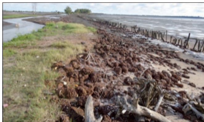
Vue d'une digue colmatée
