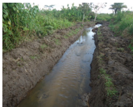
Curage du lit principal de Mvolyé de Mbockulu sur plus de 600m
