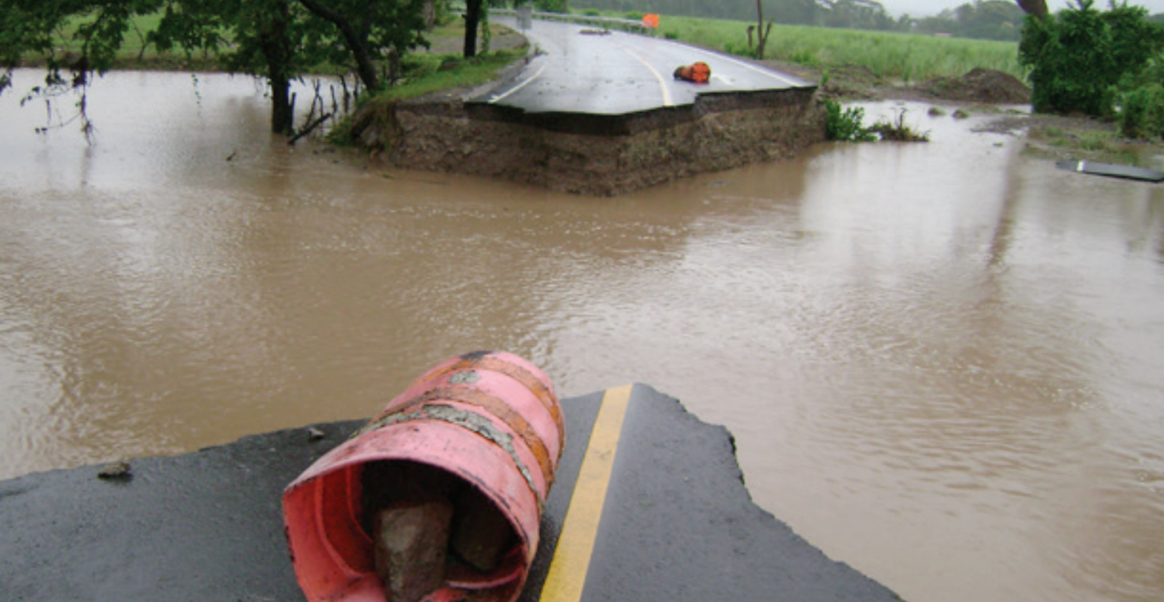
Puente caído en San Francisco Menéndez durante la tormenta 12 E, El Salvador
